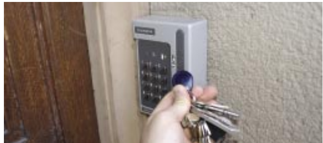
I det elektroniska låssystemet använder man sig av en plasttagg för att låsa upp dörrarna.
