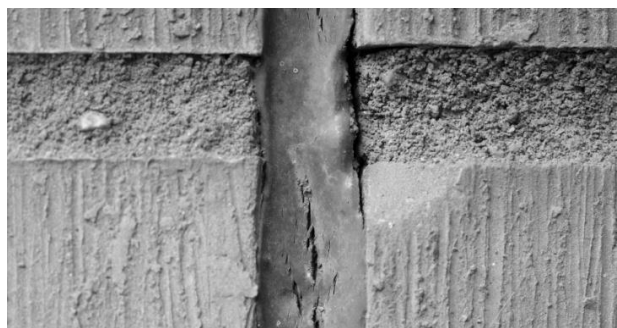
Sprickor och släpp i mjukfog på 47:ans västra fasad nära porten till 49:an. Läget är väl skyddat från sol, regn och vind.
