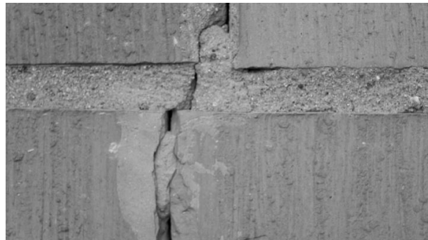
Skadad fog på 47:ans nordöstra kant nära passagen. Skadan sträcker sig mer än 2 meter.
