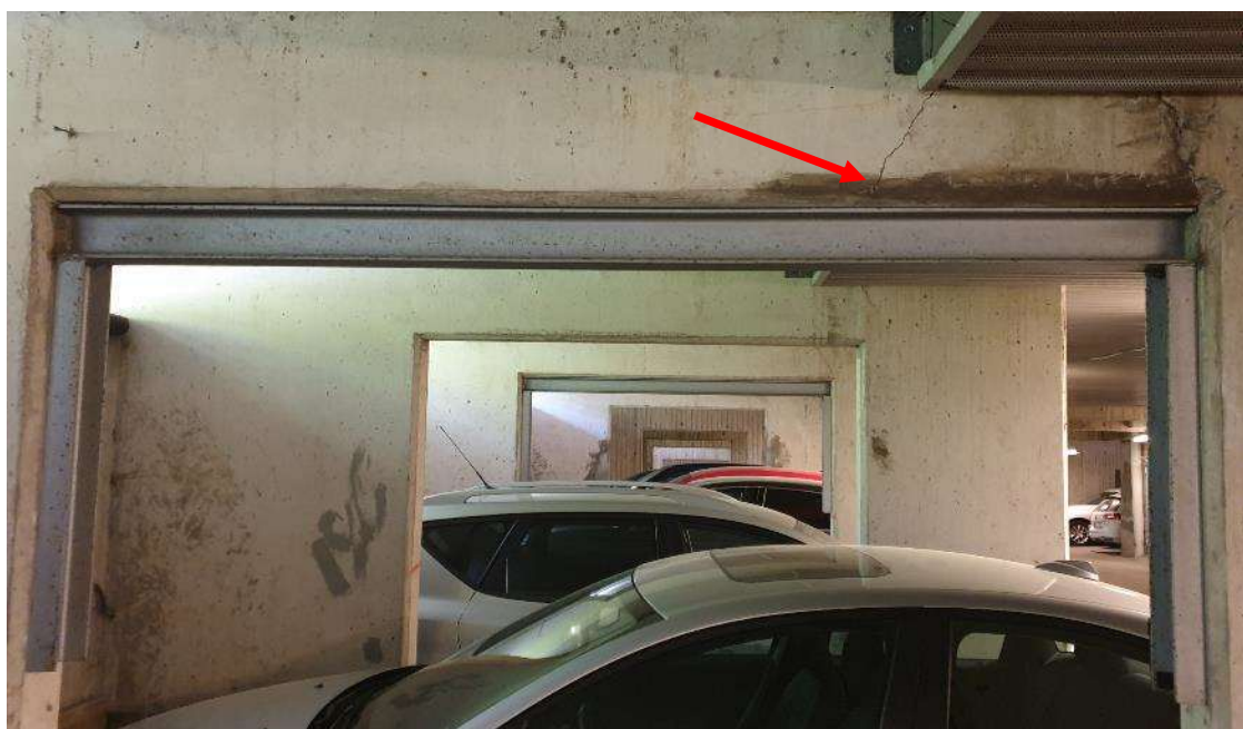
BILD 6. Spricka och stålförstärkning under betongbalk mellan pelare
