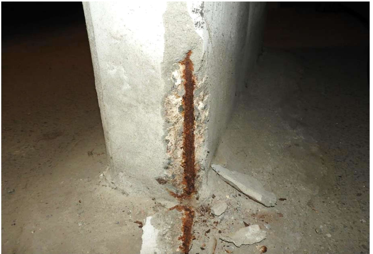
BILD 4. Rostangrepp på ingjuten armering i betongpelare
