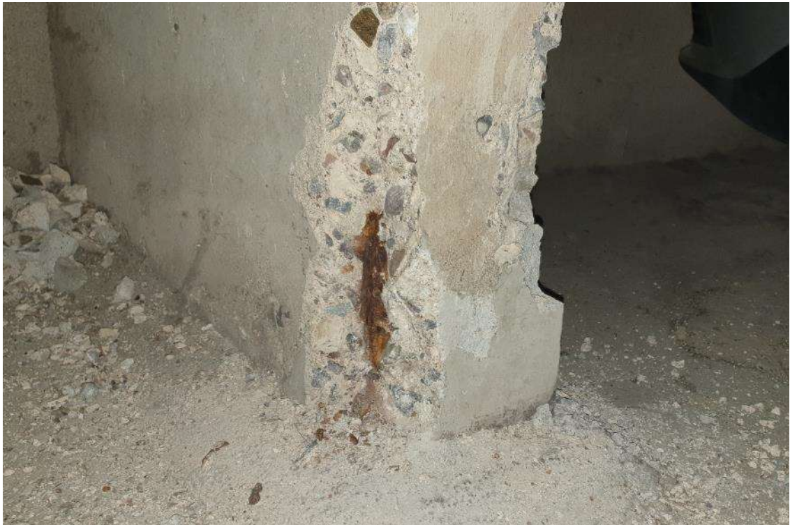
BILD 2. Rostangrepp i betongpelare
