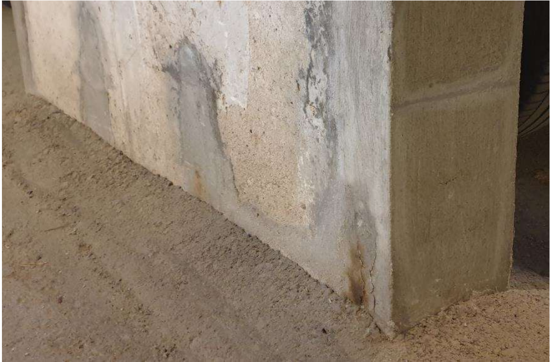
BILD 3. Återkommande rostangrepp i tidigare lagad del av betongpelare
