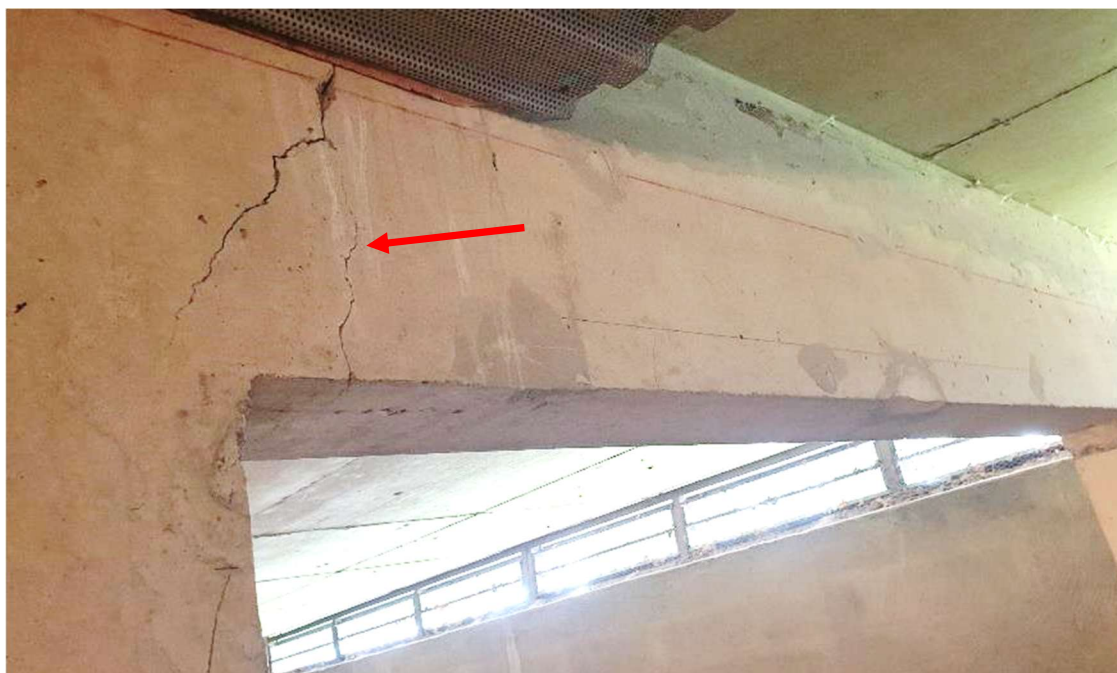
BILD 5. Spricka i betongbalk mellan pelare
